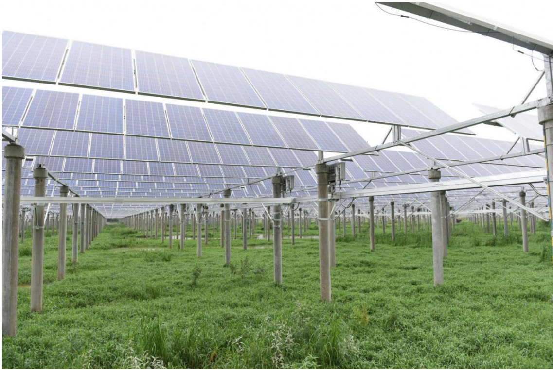
甘连光伏（广西第一个平单轴跟踪式光伏电站）
